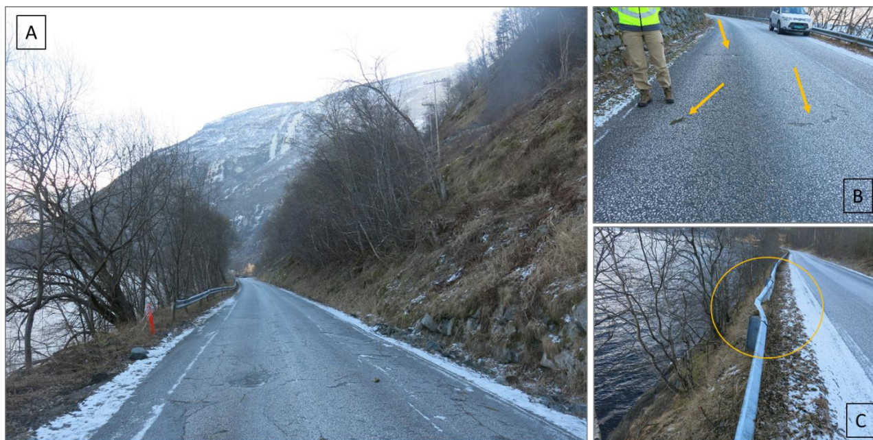
Bilde 3. A) Større skader langs veibanen som vitner om skredaktivitet i området. Se for øvrig manglende autovern og sporene i asfalten, trolig pga. skredhendelser. B) Spor i asfalten etter tidligere steinsprang. C. Bøyd rekkverk antakelig pga. steinsprang som har truffet gjerde.
